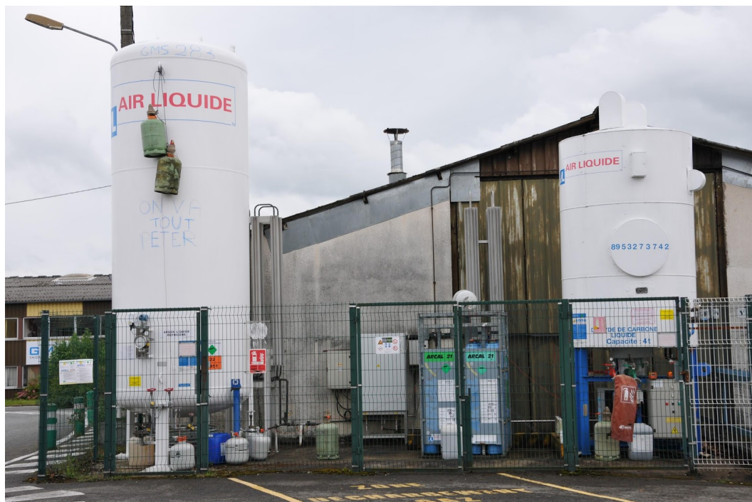
Deux bonbonnes de gaz installées sur une cuve
