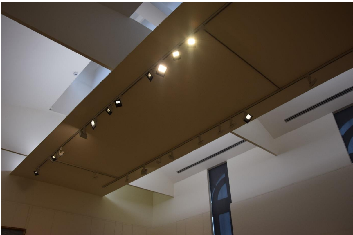
Photo. MBAQ n°8 : Salle 21 – Plafond
