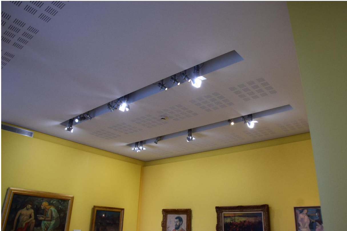
Photo. MPA n°36 : Salle 9 – Plafond
