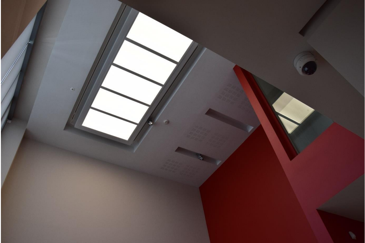
Photo. MPA n°9 : Salle 7 – Plafond
